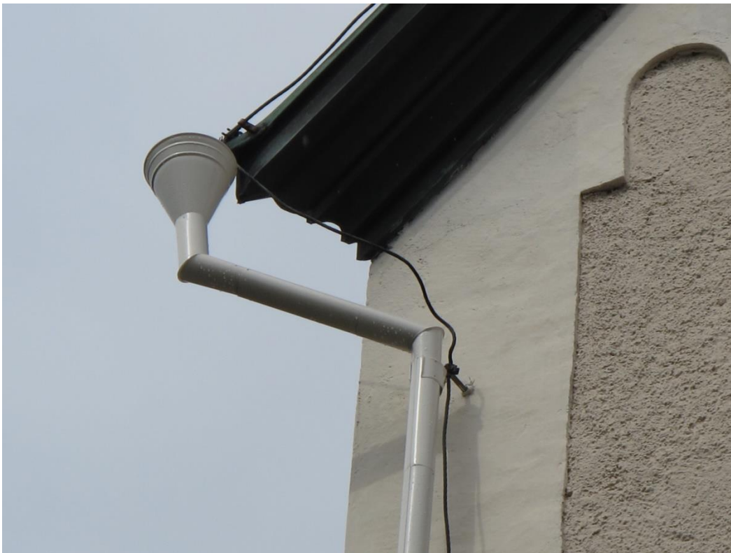
Bild 19: Nytt stuprör med skarpa krökar på tornet, 4 augusti 2016.
