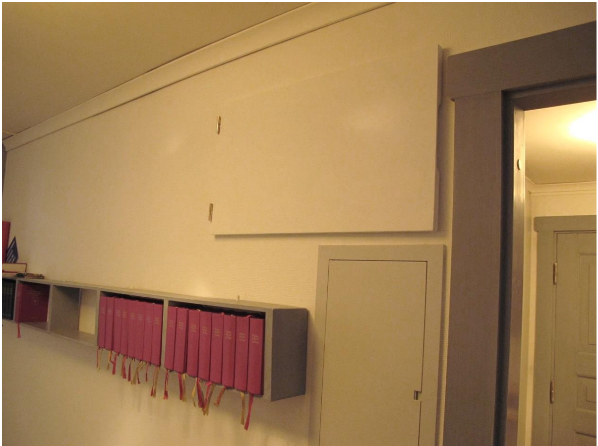
Bild 26: Larmcentral för brandlarm installerades i passage under läktare, 2 december 2015.
