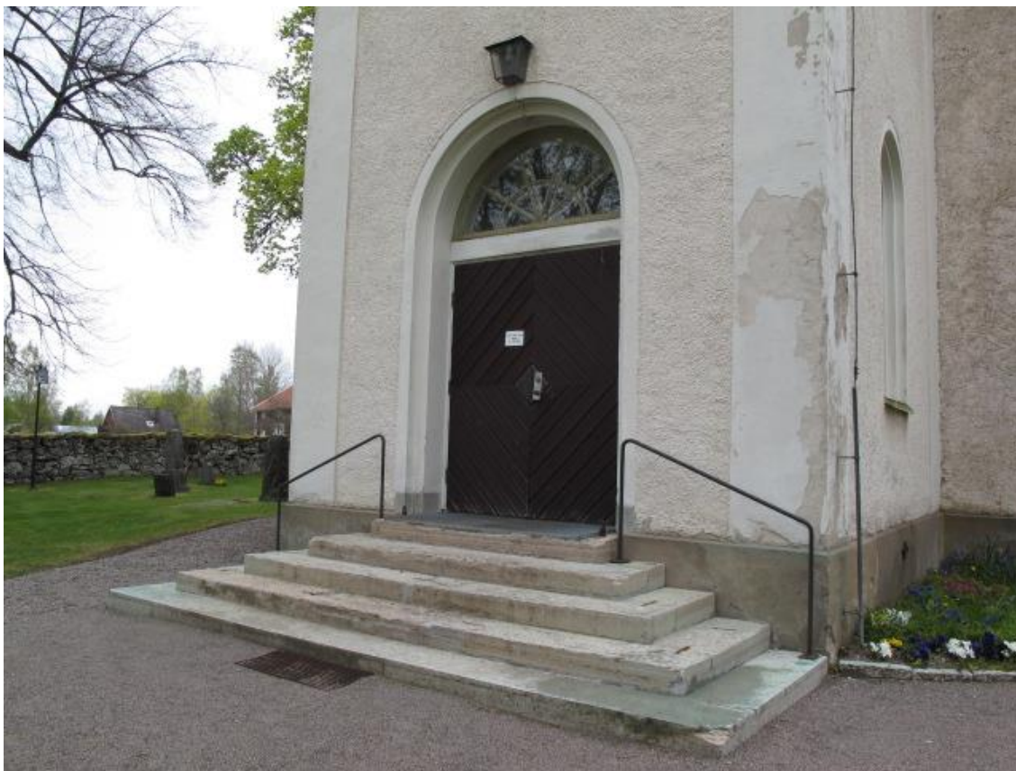
Bild 12: Västra entrén före åtgärd. Kalkstenstrappa med hakkramlor av smidesjärn, 12 maj 2015.
